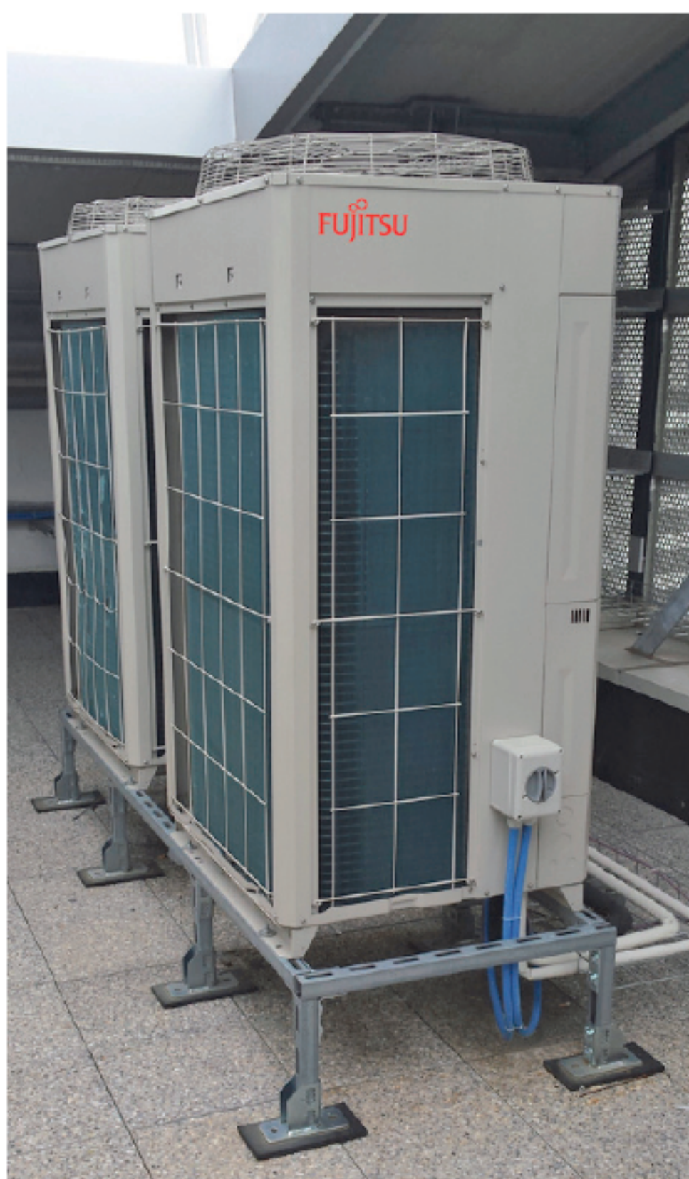
L'IMPIANTO. Il sistema VR-II di Fujitsu assicura a Casa Milan climatizzazione e raffrescamento dei locali tecnici di varia natura presenti nella struttura.
