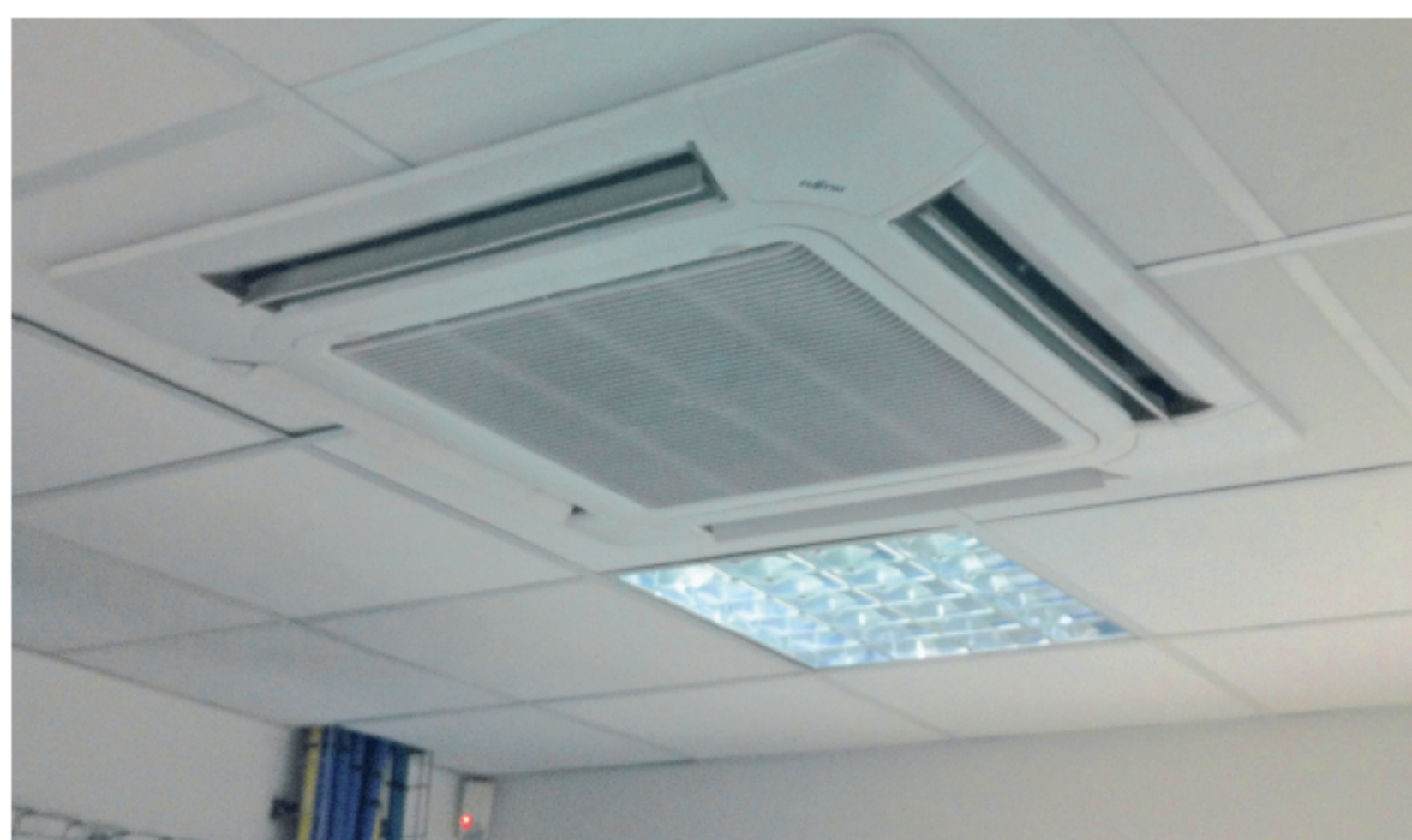
GLI IMPIANTI sono alloggiati in spazi tecnici ricavati sulla sommità dell'edificio, ben oltre i 30 m, mentre i locali interessati dall'installazione delle unità interne (nella foto) sono a una distanza ragguardevole dal tetto.
